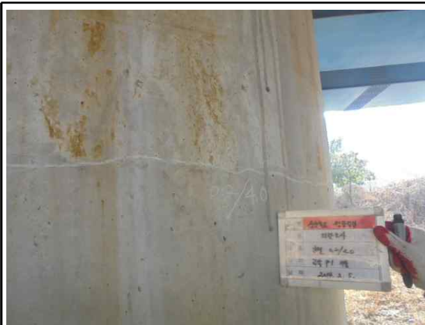
P1 기둥 c/w=0.2mm 균열
