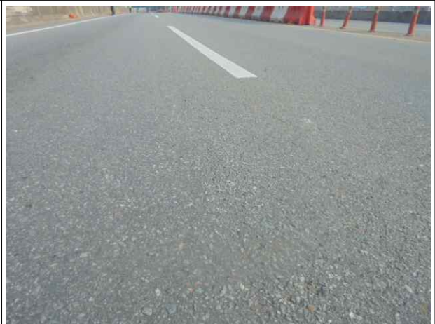
광양방향 교면포장 마모
