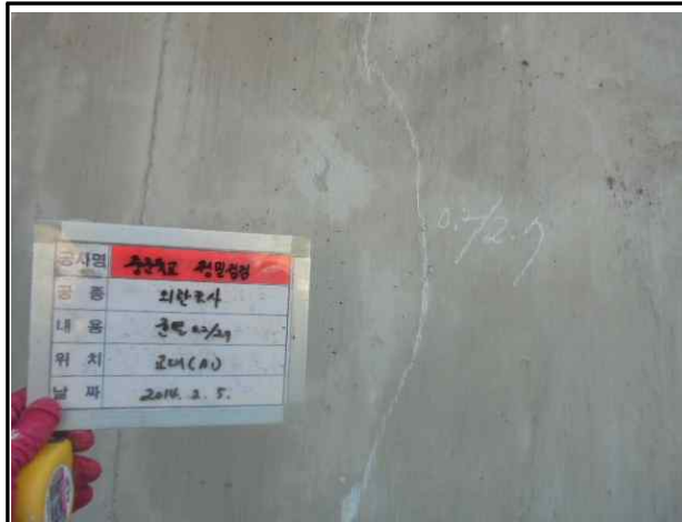
A1 교대 흥벽 c/w=0.2\text{mm} 균열
