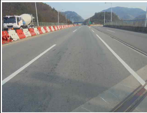
동광양방향 교면포장 소성변형
