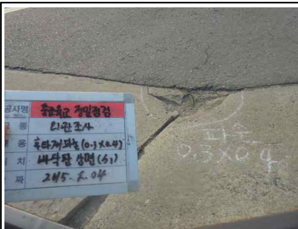
A1 Rail Joint 후타재 파손
