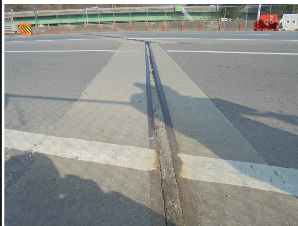
A2 Rail Joint 신축유간 토사퇴적
