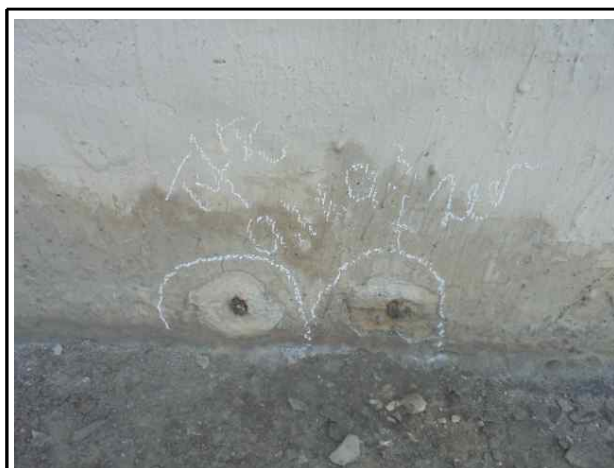
A1 교대 파손
