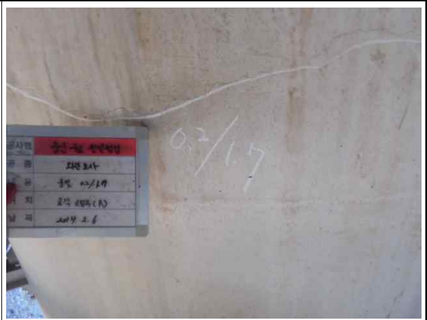
P1 코핑부 c/w=0.2mm 균열
