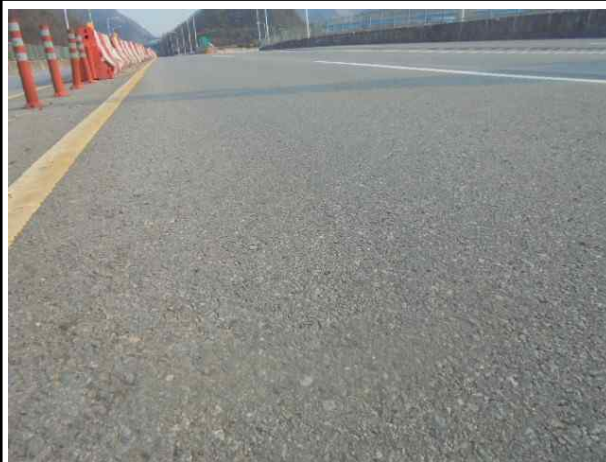
동광양방향 교면포장 마모
