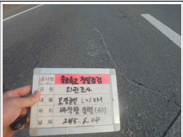
광양방향 S3 접속도로 교면포장 균열
