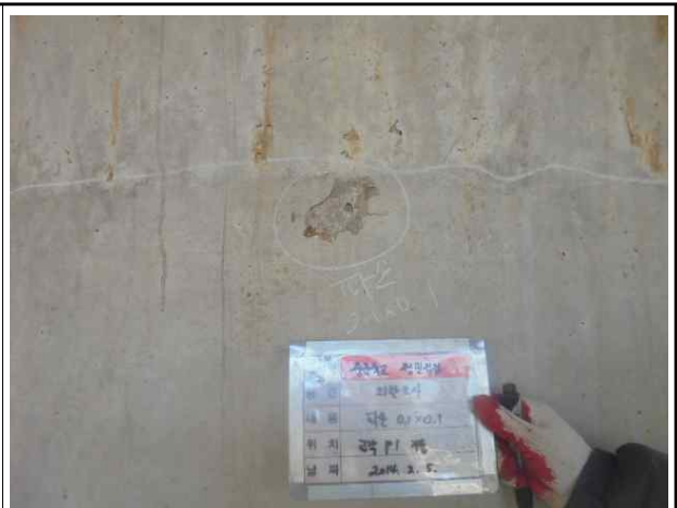
P1 기둥 파손
