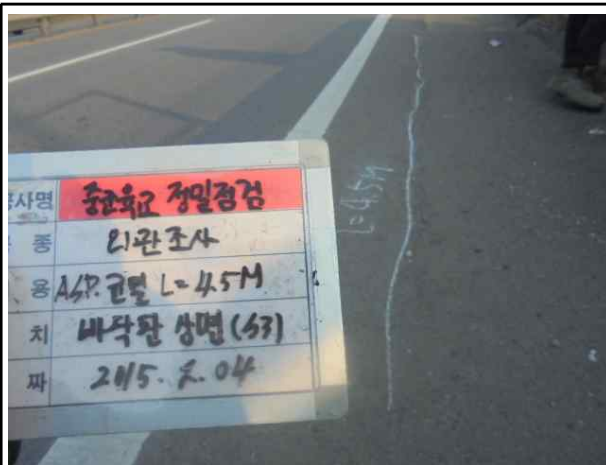
동광양방향 S3 접속도로 교면포장 균열
