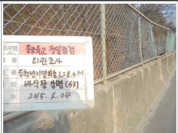
방호벽 S3 투척방지망 파손
