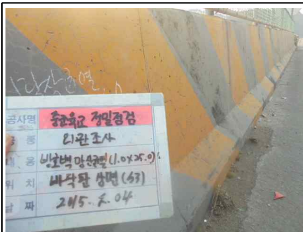
방호벽 S3 망상균열
